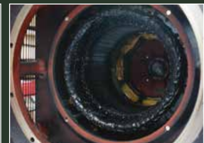
▲ Generator-Stillstandsheizung zur Vermeidung von Kondenswasser
