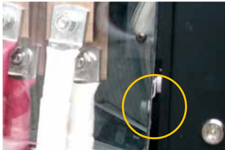
▲ Anschlusskasten mit Sicherheitsschalter
