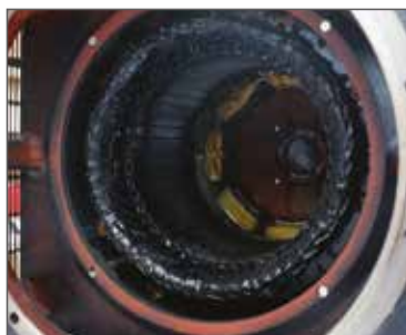
▲ Alternator anti-condensation heater / Résistance anti-condensation de l'alternateur
