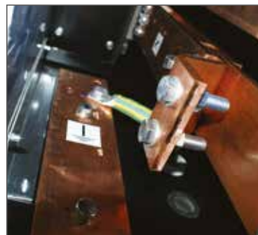
▲ Grounding connection Mise à la terre
