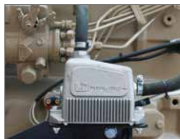
▲ Electric engine water heater Préchauffage eau électrique
