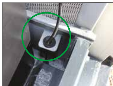
▲ Bund base alarm Alarme fuites bac de rétention
