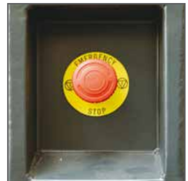
▲ Not-Aus-Schalter auf beiden Seiten des Containers
