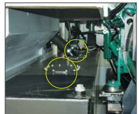
▲ Revisionsöffnungen zur Tankreinigung
