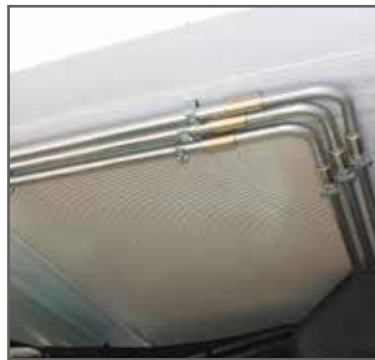
▲ Feuerbeständige Ausführung der Lichtinstallation
