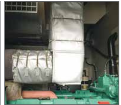
▲ Gut isolierte Abgasführung
