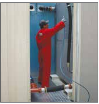
Gute Zugänglichkeit für Inspektion und Reinigungsarbeiten am Kühler Easy access to radiator for cleaning and visual checks
