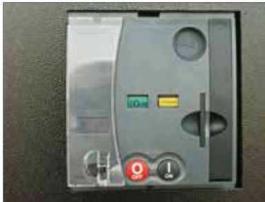
▲ Motorisierter Hauptschalter für die Synchronisierung der Aggregate
