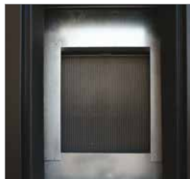
▲ Geräumiger Zugang für die Reinigung des Kühlers
