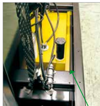
▲ Tank mit Auffangwanne
