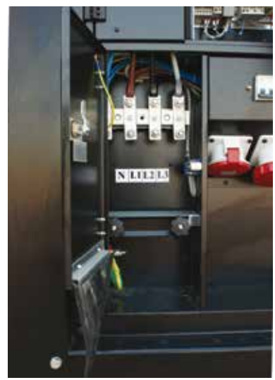
▲ Elektrischer Verteiler mit Steckdosen- und Kupferschienenabgang
